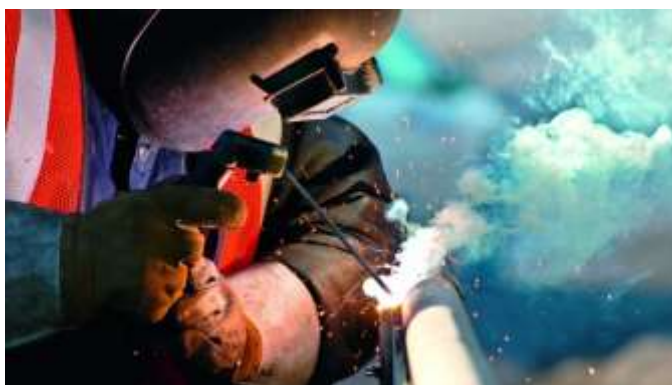
Рис.1. Виділення зварювального аерозолі.
